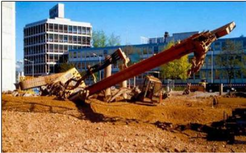
Abbildung 2 bei Bohrarbeiten 5-Zenter-Bombe angebohrt
